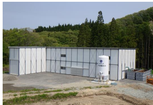
写真：濁水処理設備全景
