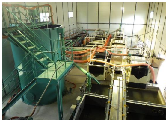
写真：濁水処理設備内部の様子 (奥側より手前側へ処理していきます)
